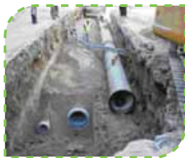
Kanalizasyon-yağmursuyu- içme boruları suyu
