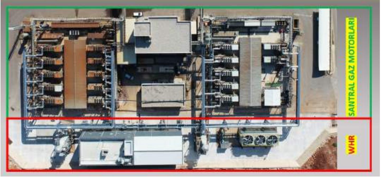
Şekil 1. Atık Isı Geri Kazanım (WHR) Tesisi
