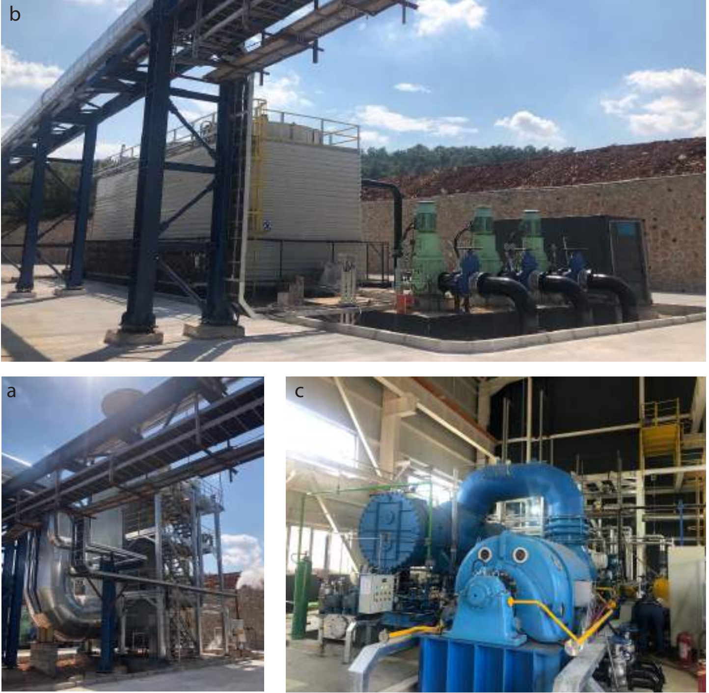
Şekil 2. WHR Tesisi Üniteleri a) Atık ısı kazanı b) Soğutma kulesi ve besleme pompaları c) Buhar Türbini/Alternatör/Kondenser
